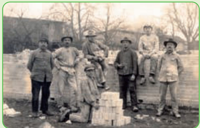
Abb. 6: Zimmermeister Wilhelm Heitmann (l.) und Maurermeister Hermann Lorenz (r.) beim Bau des Hauses von Hinr. Schnackenberg „Romoker“ 1927
